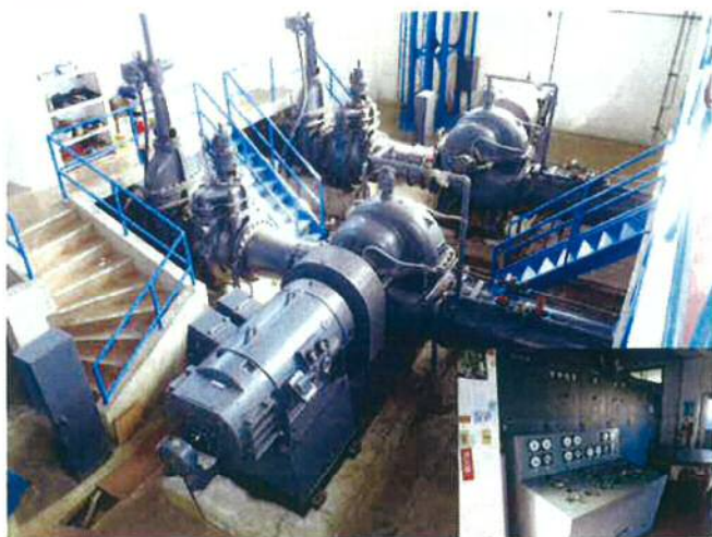
揚水機設備（2台）
