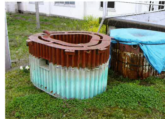
液体抵抗器の腐食状況
