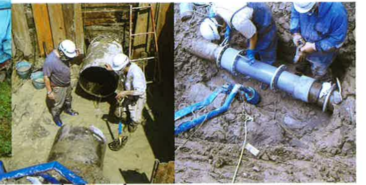
パイプラインの損傷と補修
